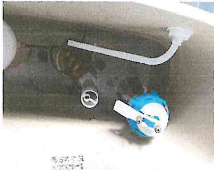
Foto 7: FALTAN ACCESORIOS EN LOS 3 SANITARIOS YA QUE ESCAPAN AGUA Y ALGUNOS SE QUEBRARON
