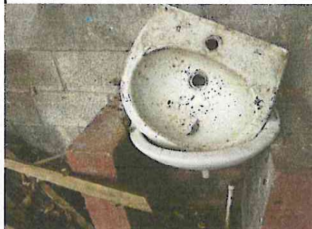
Foto 8: LAVAMANOS EN MAL ESTADO YA QUE ESTÁN QUEBRADAS LAS PARTES QUE SE AJUSTAN A LA PARED
