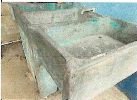
Foto 9: PILA EN MAL ESTADO CON FUGAS EN EL INTERIOR Y DAÑOS EN LOS LAVADEROS
